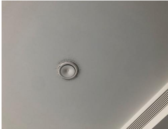
Dust to/around air vent
