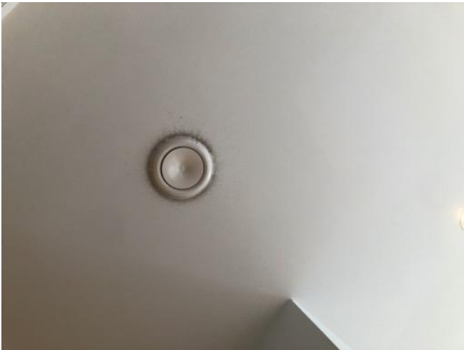
Dust to/around vent outlet
